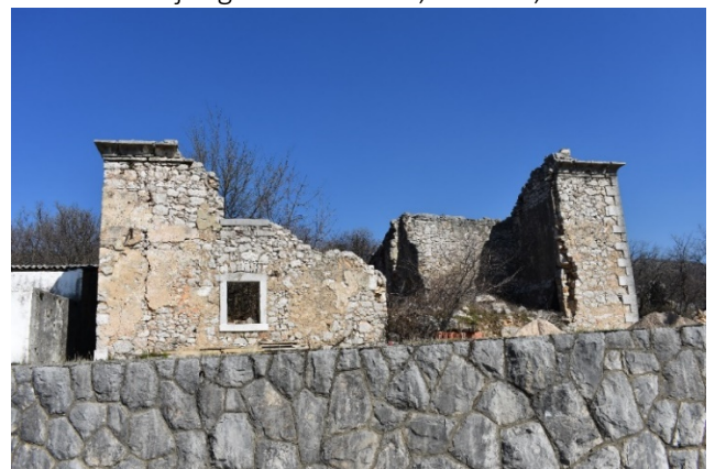
Primjer ruševne dvokatnice – građanske kuće, k.č. 253, k.o. Šmrika
